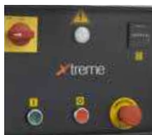
Quadro di avviamento stella triangolo con comandi in bassa tensione (24V)
