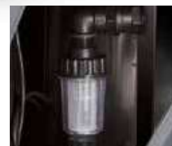
Sportello ispezione e pulizia filtro acqua
